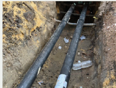
Fernwärme Johanneskirche Seite 30
